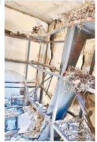
Aspectos de las residencias afectadas por el fuego.
