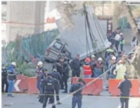
SIN HERIDOS. Las autoridades reportaron que la caída de la dovela de concreto del Tren Interurbano se debió a la falla de una grúa que trasladaba la pieza.
