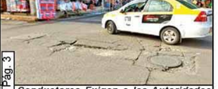
Conductores Exigen a las Autoridades Municipales que Rehabiliten las Vialidades Para Evitar Daños a sus Vehículos. Ver Pág. 3
