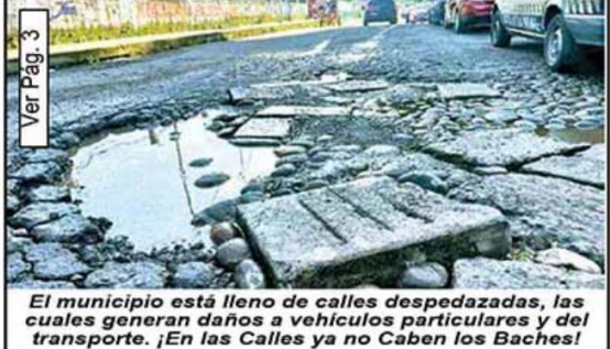
El municipio está lleno de calles despedazadas, las cuales generan daños a vehículos particulares y del transporte. ¡En las Calles ya no Caben los Baches!
