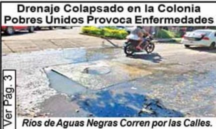
Rios de Aguas Negras Corren por las Calles.
