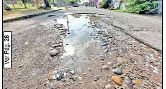
*En Pésimo Estado la Entrada a la Colonia. Ver Pág. 28
