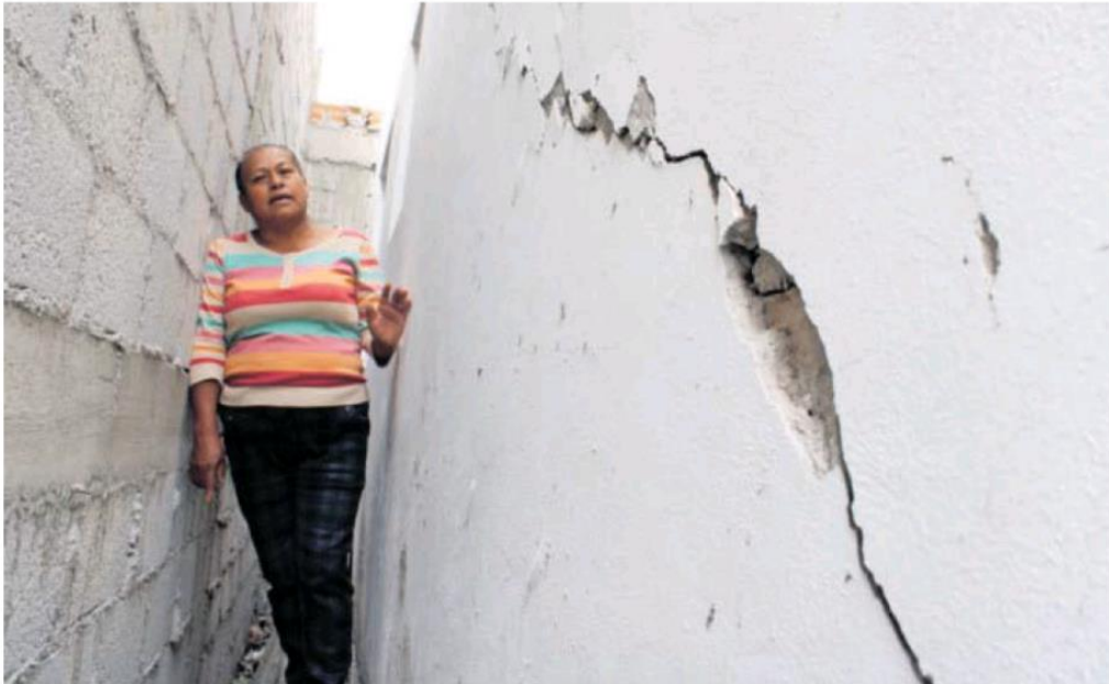
Al menos tres de las casas que entregó el gobierno de Miguel Barbosa Huerta presentan grandes grietas. /BIBIAN ADIAZ
