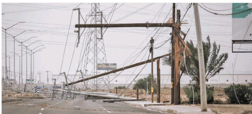
Más de una decena de postes cayeron a causa de la tormenta en la carretera a Islas Agrarias.
