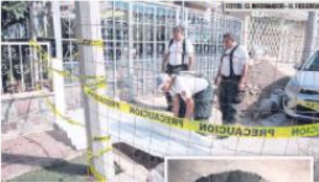
LES IMPIDEN EL PASO. Mientras la Coordinación de Protección Civil y Bomberos de Guadalajara afista la revisión de los túneles, se colocó una malla para evitar que los curiosos ingresen a la red de galerías.
