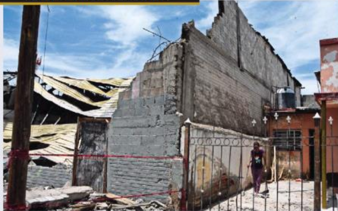
CASA ALEDAÑA al negocio que quedó completamente destruido
