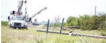
■ A la altura del filtro de la Policía Estatal, en los límites de Coahuila y Nuevo León se aprecia parte de la postera de concreto de CFE que derribó un tornado el sábado.
