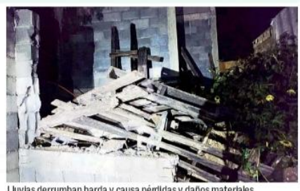
Lluvias derrumban barda y causa pérdidas y daños materiales.
