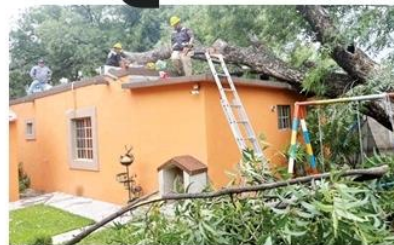
El nogal de más de 30 metros de altura cayó sobre el techo de una vivienda.
