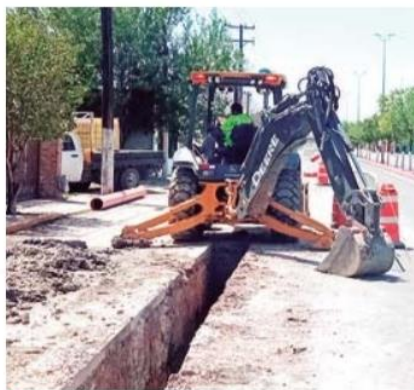
Obras de drenaje han ayudado a dar mayor fluidez al agua durante las lluvias.
