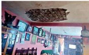
Vecinos reportan grietas y desprendimientos en sus casas.
