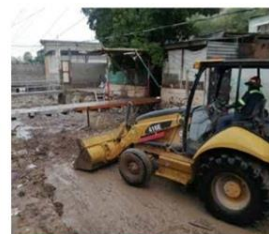
AVANZAN LAS LABORES de atención a damnificados, levantamiento de censos y limpieza del área afectada por las lluvias.
