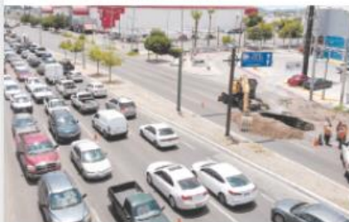
• ‘Caos vial’ en bulevar Solidaridad y Paseo del Río, donde hay un socavón debido al desperfecto de un tubo de 16 pulgadas del sistema del drenaje.
