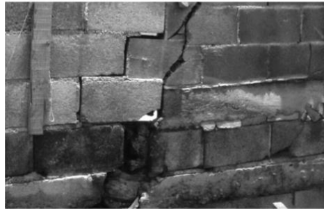
Desde hace más de 20 años los vecinos de las colonias Balcones de Santa Fe, Manantiales del Valle, Las Haciendas, Guanajuato y Misiones de Manantiales han padecido el problema.
