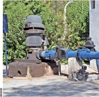
Nuevas fallas en el servicio de la CFE, vuelven a dejar afectaciones en la operación de distintos equipos del Simas Torreón.
