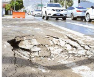
La gerencia técnica del Simas Torreón admitió la posibilidad de mayores colapsos en redes de drenaje durante los próximos días.
