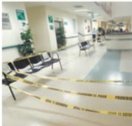
Daños. La lluvia provocó goteras en el Centro Estatal del Adulto Mayor.
