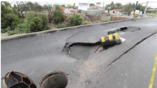
Las intensas lluvias dejaron en evidencia anomalías en la obra, entregada hace unos meses.
