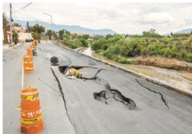
Humedad. Peligroso hundimiento se formó en la calle Tezcatlipoca, en la colonia Los Pinos.
