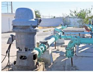
Otra vez la Comisión Federal de Electricidad generó apogones en bombas de extracción de agua potable del Simas Torreón.
