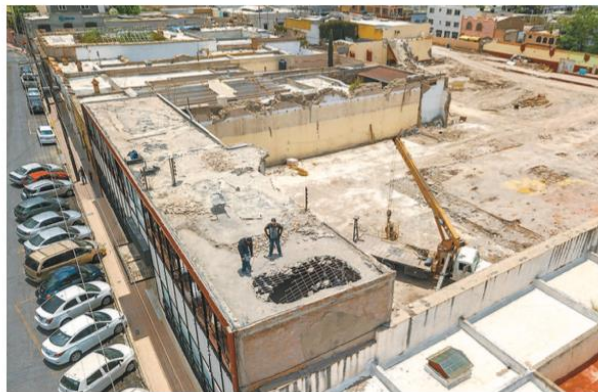
Destrucción. Ya solo queda en pie lo que funcionaba como oficinas; del Patio Español, los billares, la cocina, baños de vapor y el gimnasio, solo quedan ruinas.
