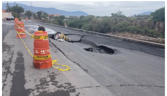
Socavón al lado de arroyo Ceballos, calle y arroyo recién reparados por el gobierno municipal en esta administración.
