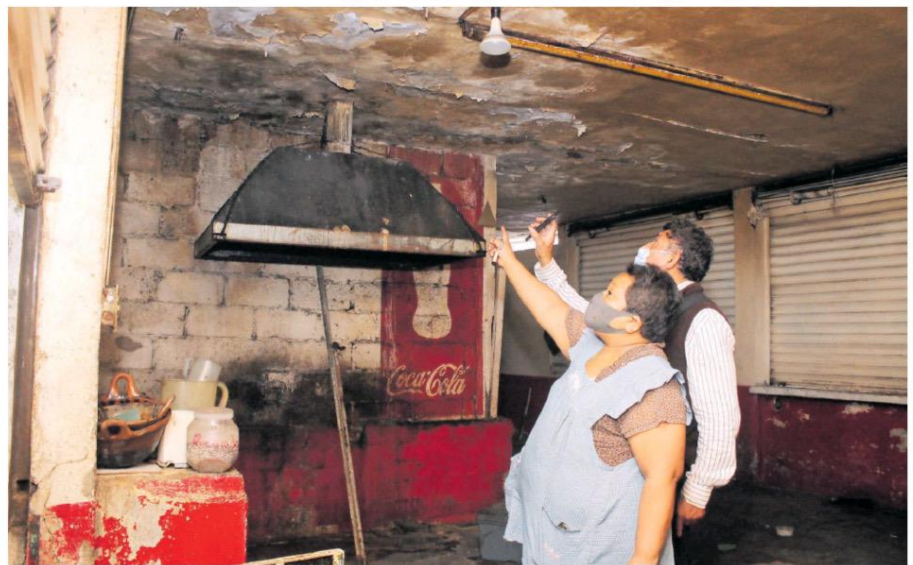
Algunos locales del Mercado Amalucan tienen filtraciones de agua en el techo, falta de pintura, así como grietas en las paredes, en su mayoría son los que se encuentran ubicados al fondo del lugar. Ayer, Protección Civil informó que detectaron un socavón en el inmueble / JULIO CESAR M.
