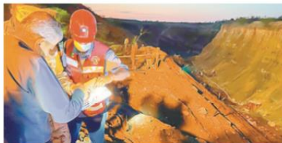
Sin escatimar. Autoridades estatales se dirigieron al lugar para coordinar los trabajos de rescate; Gobierno federal también envió apoyo.
