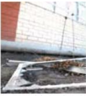
La mayoría de las escuelas están vandalizadas.
