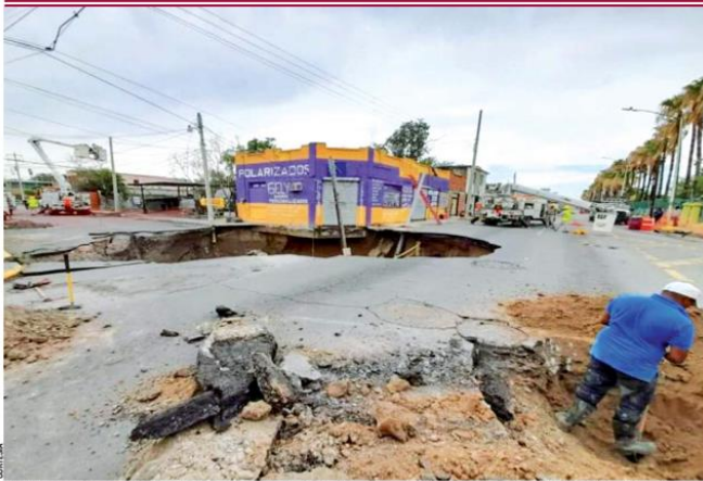
Alerta nuevo socavón. En alerta se encuentran los ciudadanos y las autoridades en Nuevo Laredo, Tamaulipas, luego de que se formara un enorme socavón de más de veinte metros de profundidad en el cruce de las calles González y América. [NACIONAL 4A]
