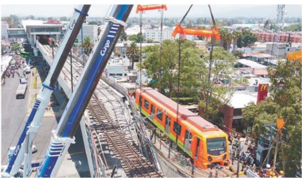
Uno de los vagones que cayó del tramo elevado de la Iztapalapa Línea Dorada fue removido con dos enormes grúas para trasladarlo a los talleres del Metro. Autoridades cercaron el perímetro para evitar más accidentes.
