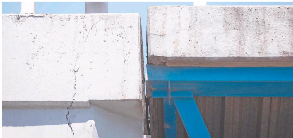
• Estas son las imperfecciones que presenta el "puente pando", una de las restricciones en dicho punto es la no subida de vehículos de carga o transporte pesado.
