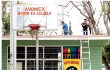
ALGUNAS ESCUELAS SUFRIRON deterioro debido a que han permanecido más de un año cerradas.
