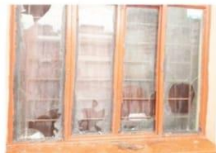
Protección Civil aún no termina con el recuento de daños.
