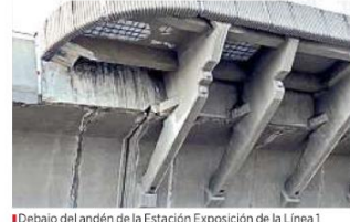
Debajo del andén de la Estación Exposición de la Línea 1 se observan grietas, desgajamientos y varillas expuestas.
